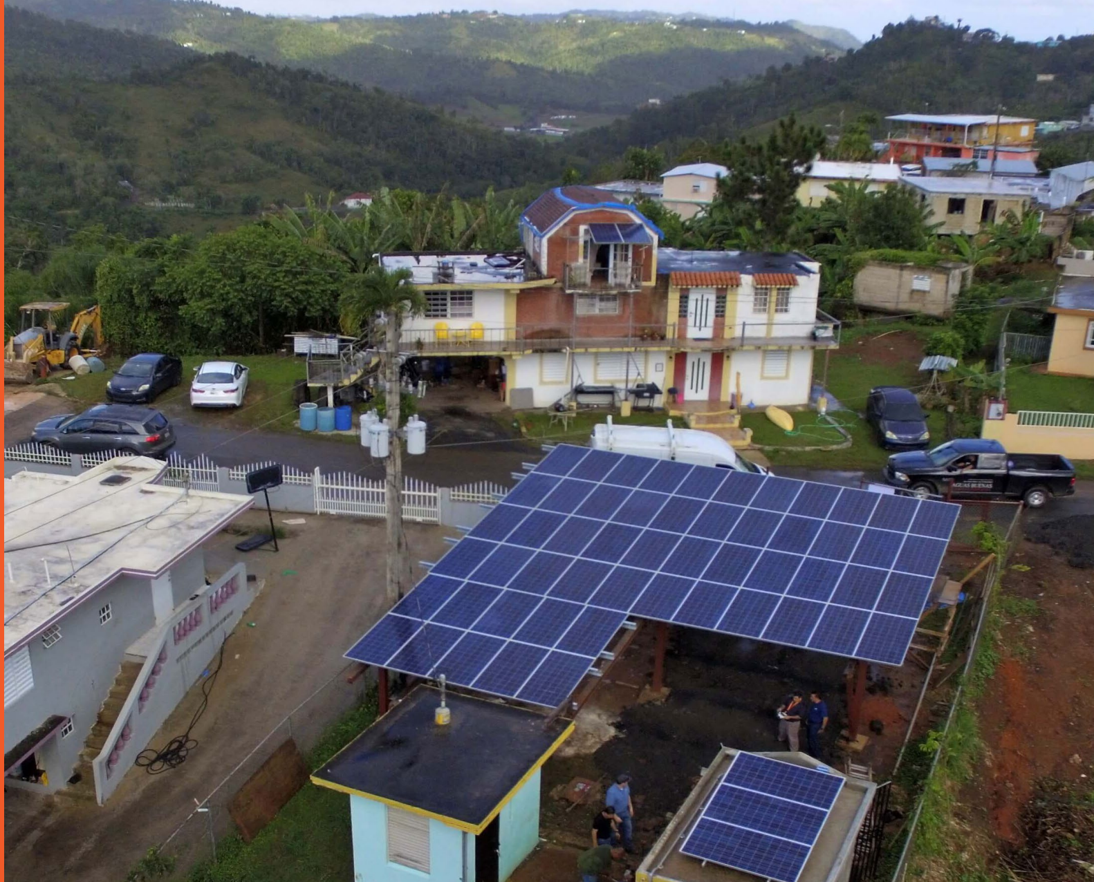
Acueducto Comunitario Las Corujas en Aguas Buenas,
